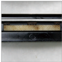
下部給油パッドは正常に設置、正常に給油
